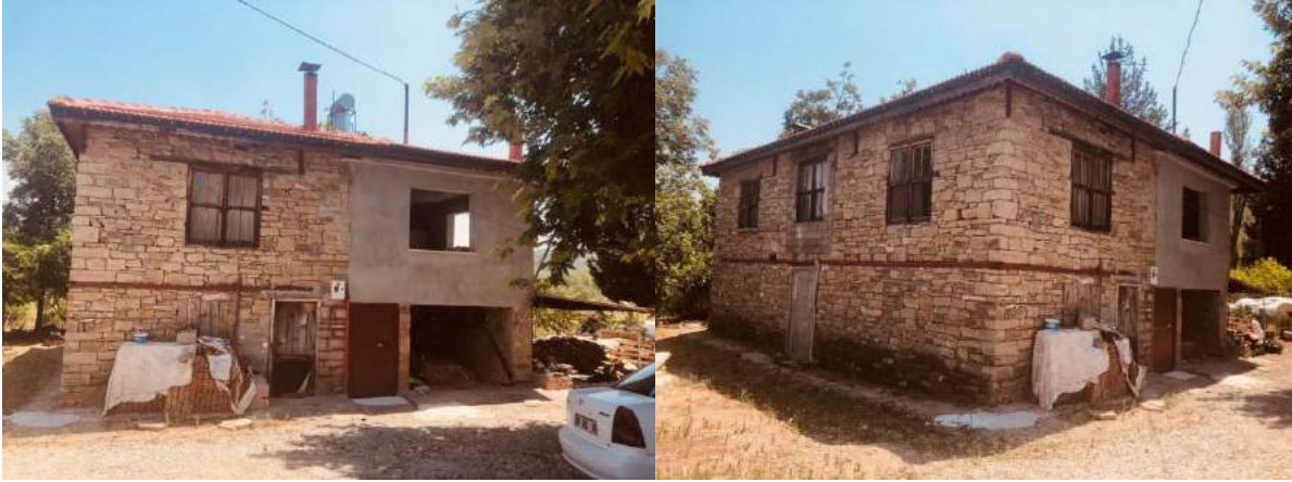
Şekil 4 Geleneksel Köy Evine Sonradan Betonarme Ekleme Yapılmıştır (Arıcı, 2021)
